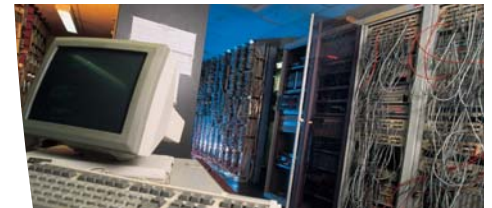
Intégration dans les racks à forte densité.
